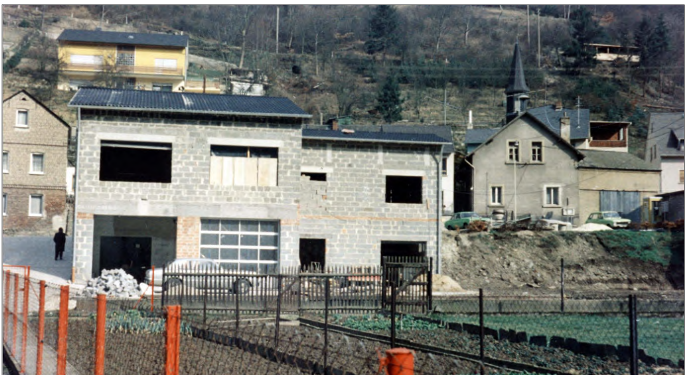
Das neue Dorfgemeinschaftshaus am 6.3.1977 im Rohbau; rechts dahinter das alte Rathaus – noch mit Glockenturm, welcher am 25.3.1982 neben die Friedhofskapelle umgesetzt wurde (entgegen dem Rat der Denkmalschutzbehörde).
