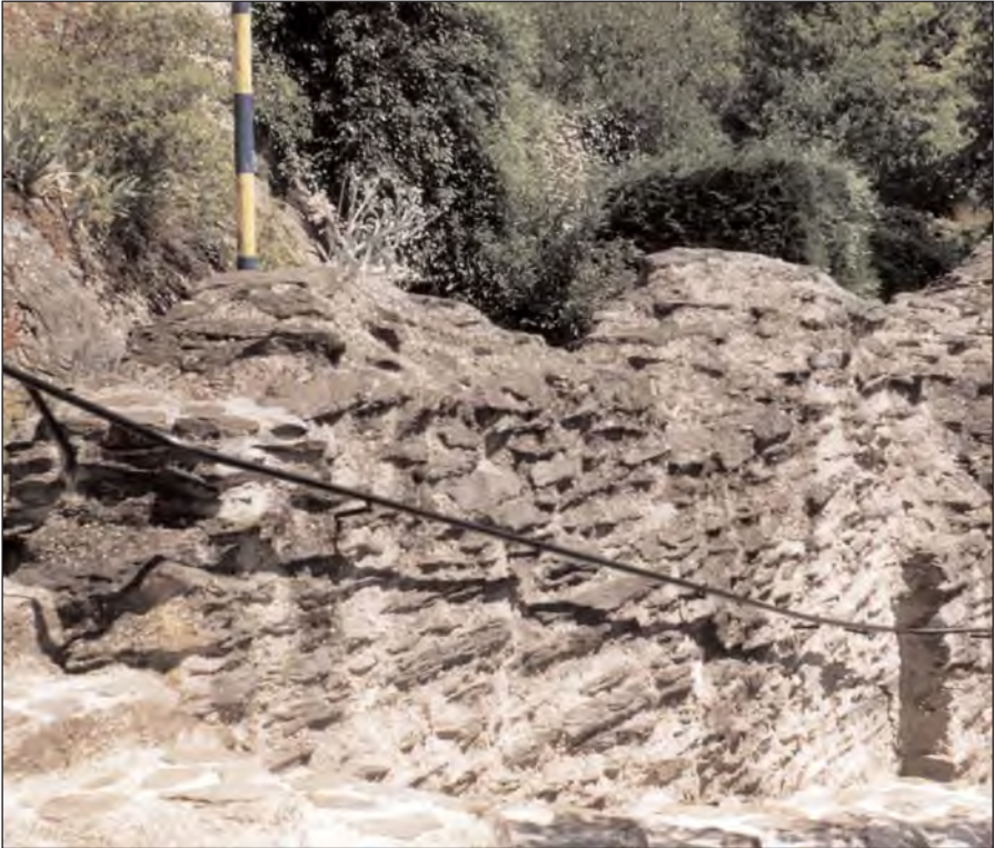
Das Foto zeigt die ruinöse und buckelige Stützmauer, die den Aufstieg zum Bergfried gestaltet
